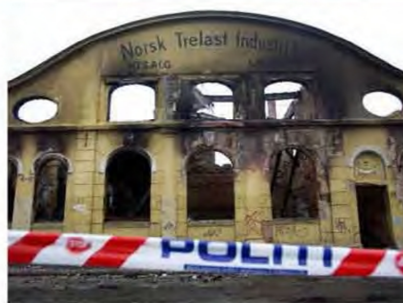
UKJENT ÅRSAK: Den verneverdige trelasthallen i Schweigaardsgate 28 i Oslo brant i november 2003. Brannårsaken er fortsatt ukjent. Foto: Scanpix
